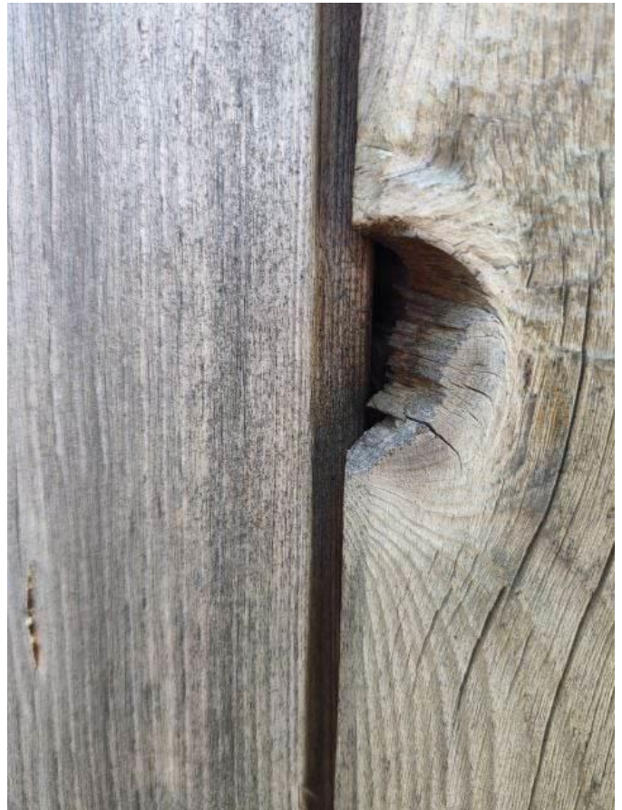
Nr 13 – ubytek deski
