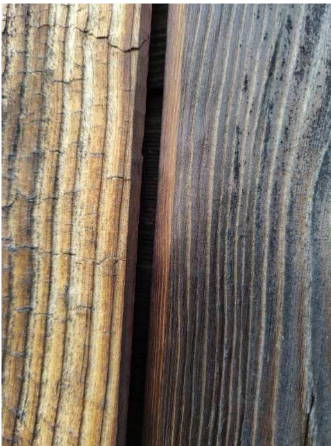
Nr 18 deska w zbliżeniu – pęknięcia desek
