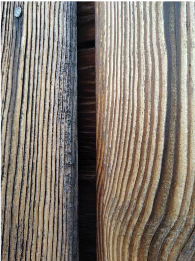
Nr 14 deska w zbliżeniu – szczelina około 1 cm.
