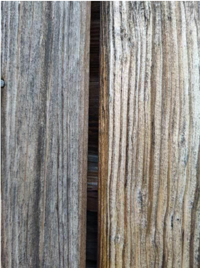
Nr 12 deska w zbliżeniu – szczelina około 1 cm.
