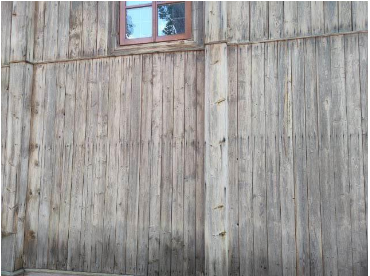
Nr 6 – deski szalunkowe na elewacji północnej
